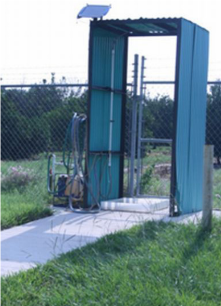
Figura 11a. Estación automática de descontaminación personal.
